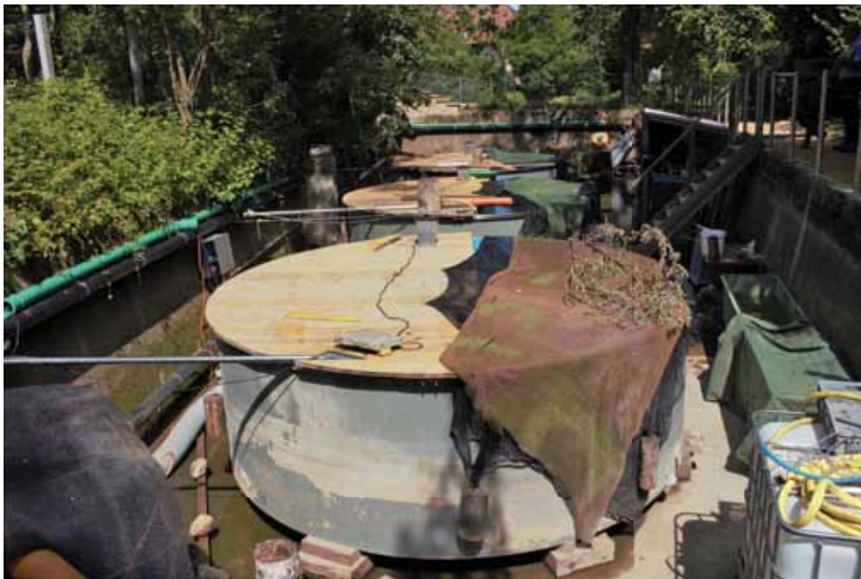
In Giebenach bei Basel wird die Wasserqualität mit dem Netilion Smart System für Aquakulturen von Endress+Hauser überwacht. (Bilder: Endress+Hauser)
